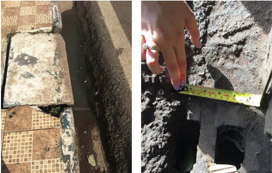
(a) BL totalmente obstruída
