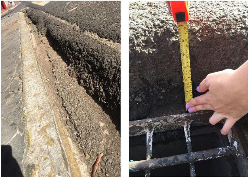
(a) Elevação do pavimento em relação a guia
