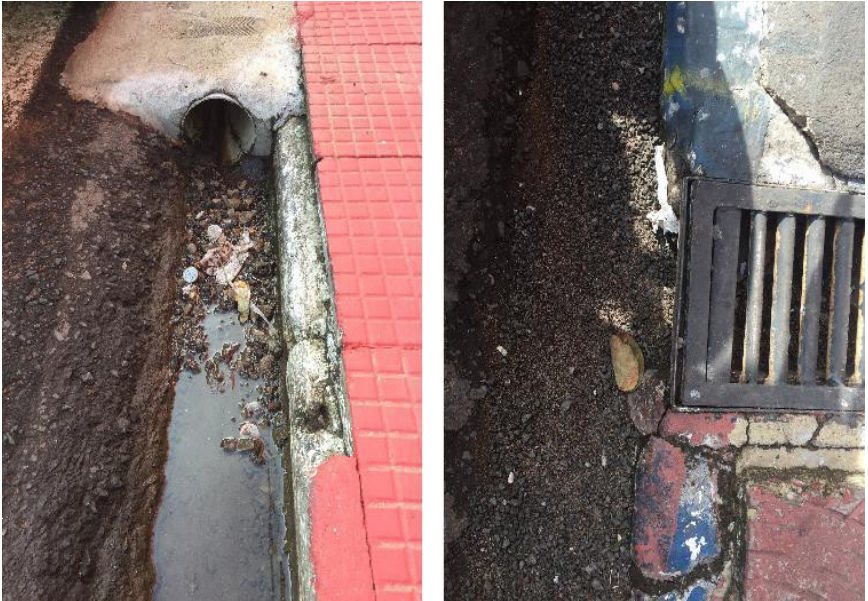
(a) Obstrução da sarjeta
